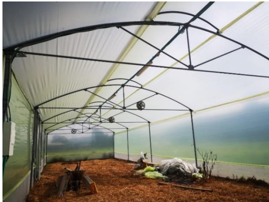
Figura 3. Ventiladores de entrada de aire fresco y de circulación interior.
